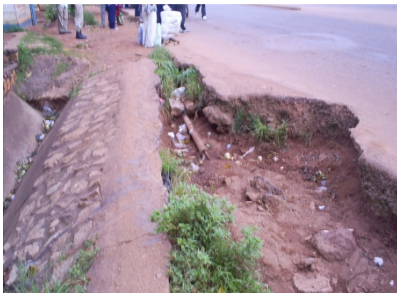
Photo 1 : Dégradation d'une voie à Gobongo (cliché : Eténé, septembre 2010).
