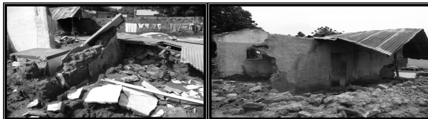
Figure 6: Destruction de bâtiments en banco dans les quartiers de Taliba et de Santhiaba (A.A.FALL, 2010)
