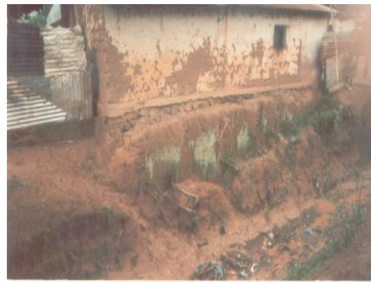
Photo 2 : Ravinement d'un bâtiment à Boy-rabe (cliché : Eténé, septembre 2010).
