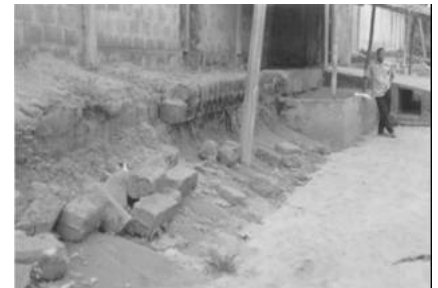
Photo 5 – Technique de terrasse pour lutter contre le déchaussement Alomè Cliché : Etene octobre 2005
