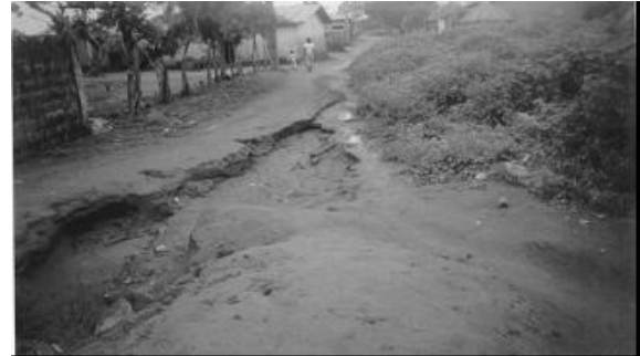
Photo 2 – Rue presque entièrement détruite par l'érosion pluviale à Gbégamey. Cliché Etene, juin 2004
