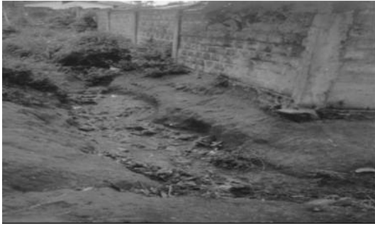
Photo 1 – Ravinement d'une clôture de la maison à Dogoudo. Cliché : Etene, juin 2005
