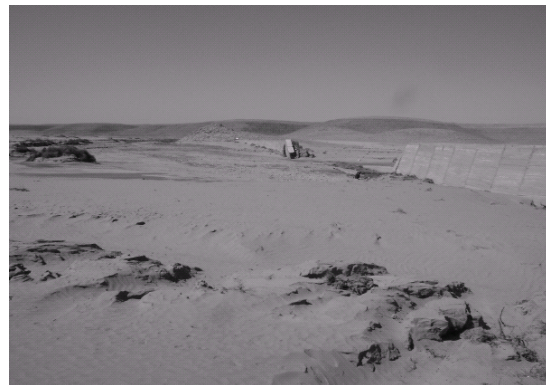
Figure 4. L'effondrement de la retenue collinaire
