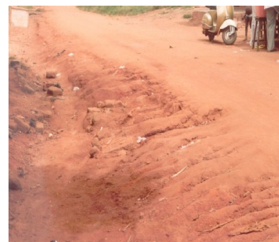
Photo 4 : Etat de dégradation d'une rue de Mandamba Cliché Eténé, septembre 2006 Source : Enquête de terrain, 2006
