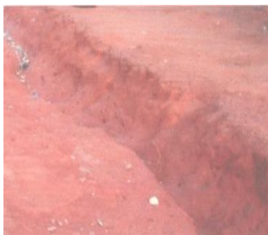
Photo 3 : Rue détruite par l'érosion pluviale à Kaïmba Cliché Eténé, septembre 2006 Source : Enquête de terrain, 2006
