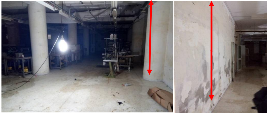
Figure 5. Niveau maximal atteint par l'eau dans un atelier installé dans un sous-sol (HTI).
