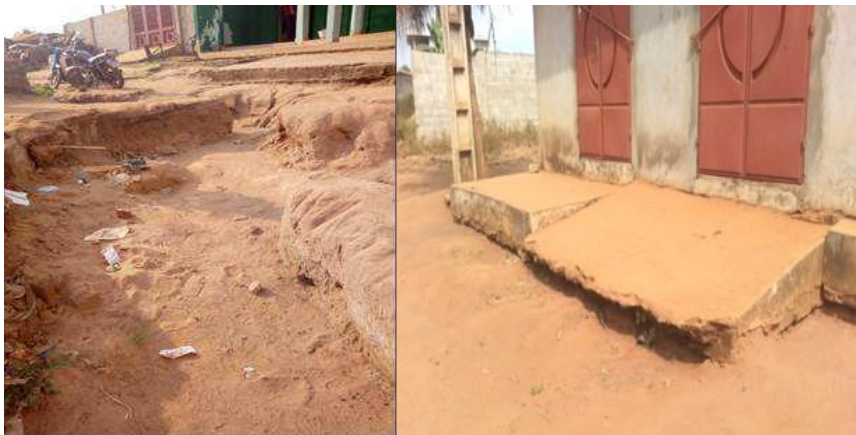
Figure 7. Ruelle détruite par une ravine à Tanto Porto-Novo (à gauche) et déchaussement d'un système de protection par l'érosion à Vakon Akpro-Misséré (à droite) (Clichés : Eténé, juin 2019)
