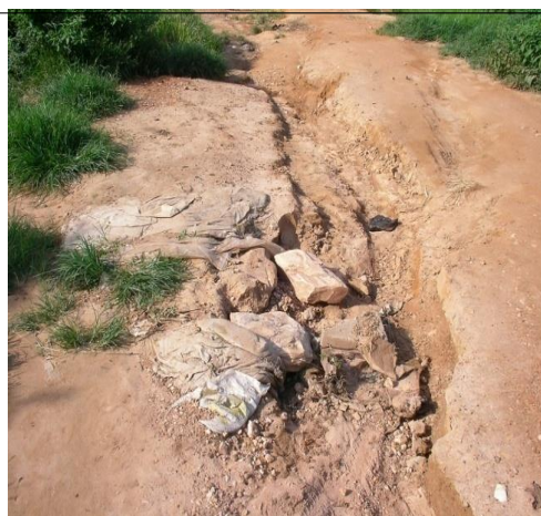
Photo 2 : Ravinement d'une rue vers Fourignikèrè
