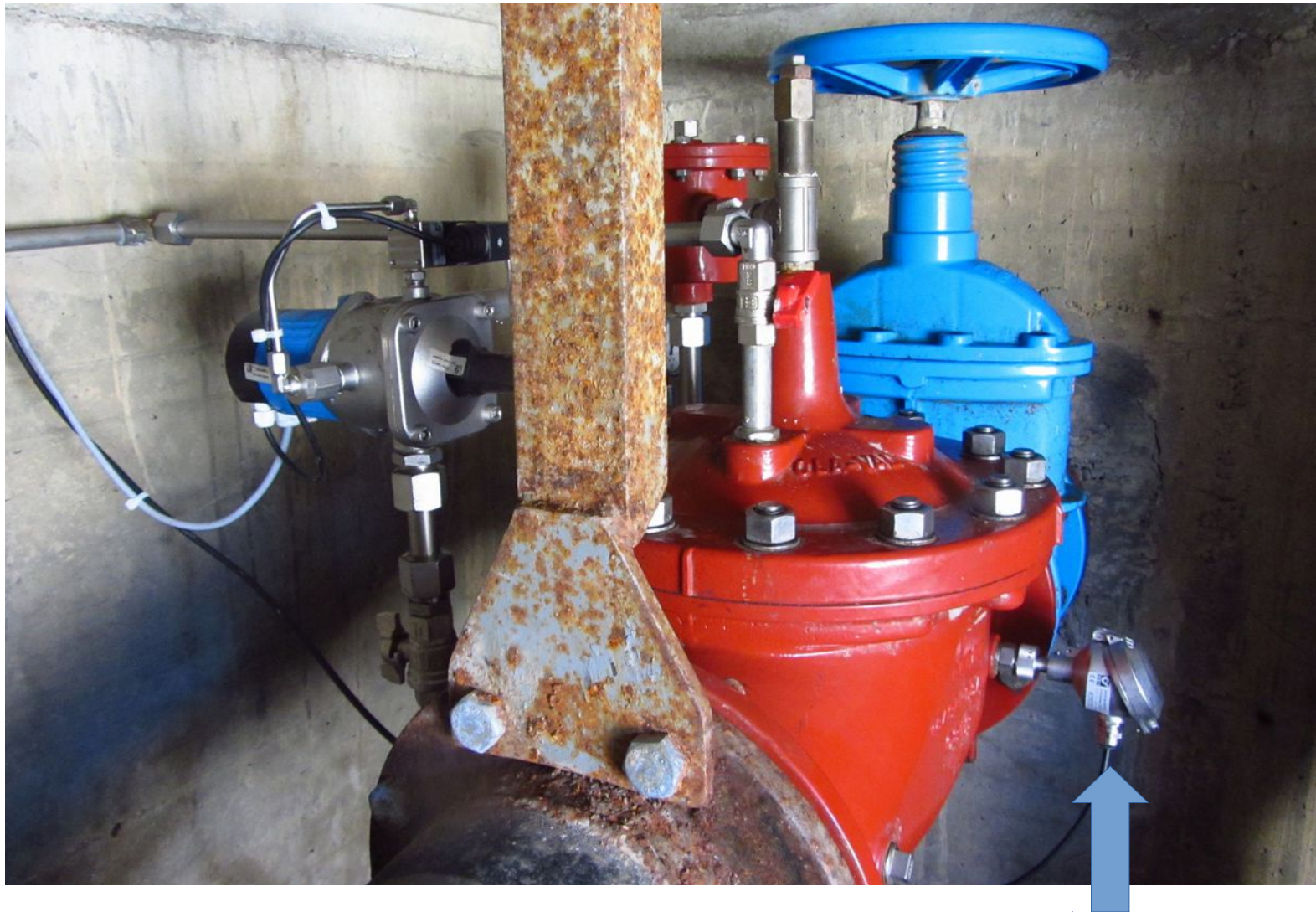
Débitmètre en tête de réseau d'irrigation. Eau distribuée à l'entièreté du vignoble : résolution \text{m}^3/\text{h}
